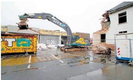
Ab in den Container: Konsequente Mülltrennung ist auch auf Großbaustellen gängige Praxis, um Wert- und Schadstoffe auszusortieren.
